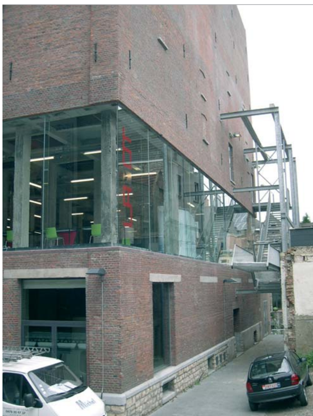
Aan de achterkant van gebouw Lamot is een nieuwe vliesgevel met Thermobel Energy glas van AGC opgenomen in de oude baksteen gevel. Foto: Rik Vollebregt
